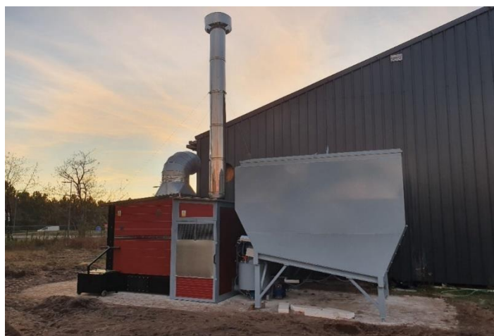
Figure 42 : Photo d'une chaudière (générateur d'air chaud) alimenté en bois déchiqueté. Cette chaudière alimente un séchoir à bois d'une capacité de 5.000 tonnes par an. (Le Barp – 33) (Source : AS DEV.)
