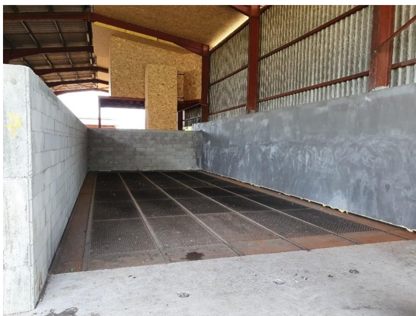
Figure 39 : Photo d'une cellule de séchage composée de grilles à pontets soudées sur une structure en acier (IPE de 100 croisés sur IPN de 300) (Came – 64) (Source : AS DEV.)
