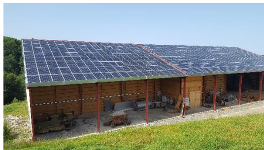
Figure 41 : Photo d'un séchoir fourrage vrac. 100% alimenté en air chaud par la toiture solaire. (Lohitzun – 64) (Source : AS DEV.)
