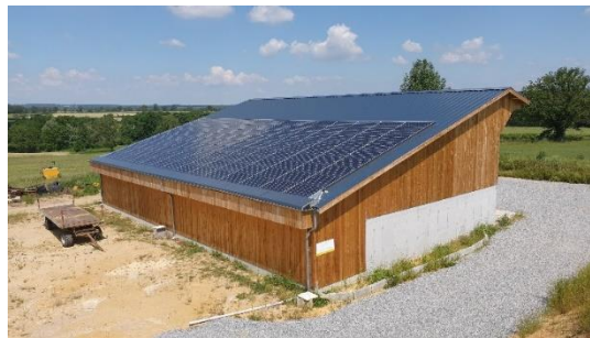
Figure 40 : Photo d'un séchoir fourrage + céréales + bois. 100% alimenté en air chaud par la toiture solaire. (Agonges – 03) (Source : AS DEV.)
